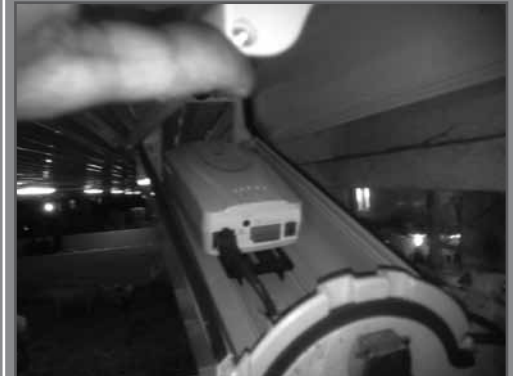
Caméra à l'intérieur du boîtier, remarquez le branchement avec le fil réseau.
