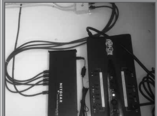
L'installation réseau : à gauche le multiplexeur et à droite le parasurtenseurs pour la protection contre les variations de courant (très important), et en haut les connexions pour les caméras.
